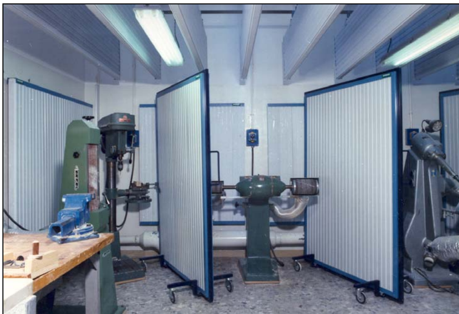
Figura 18 – Porzione di un ambiente basso con schermi acustici abbinati ad un trattamento fonoassorbente.
